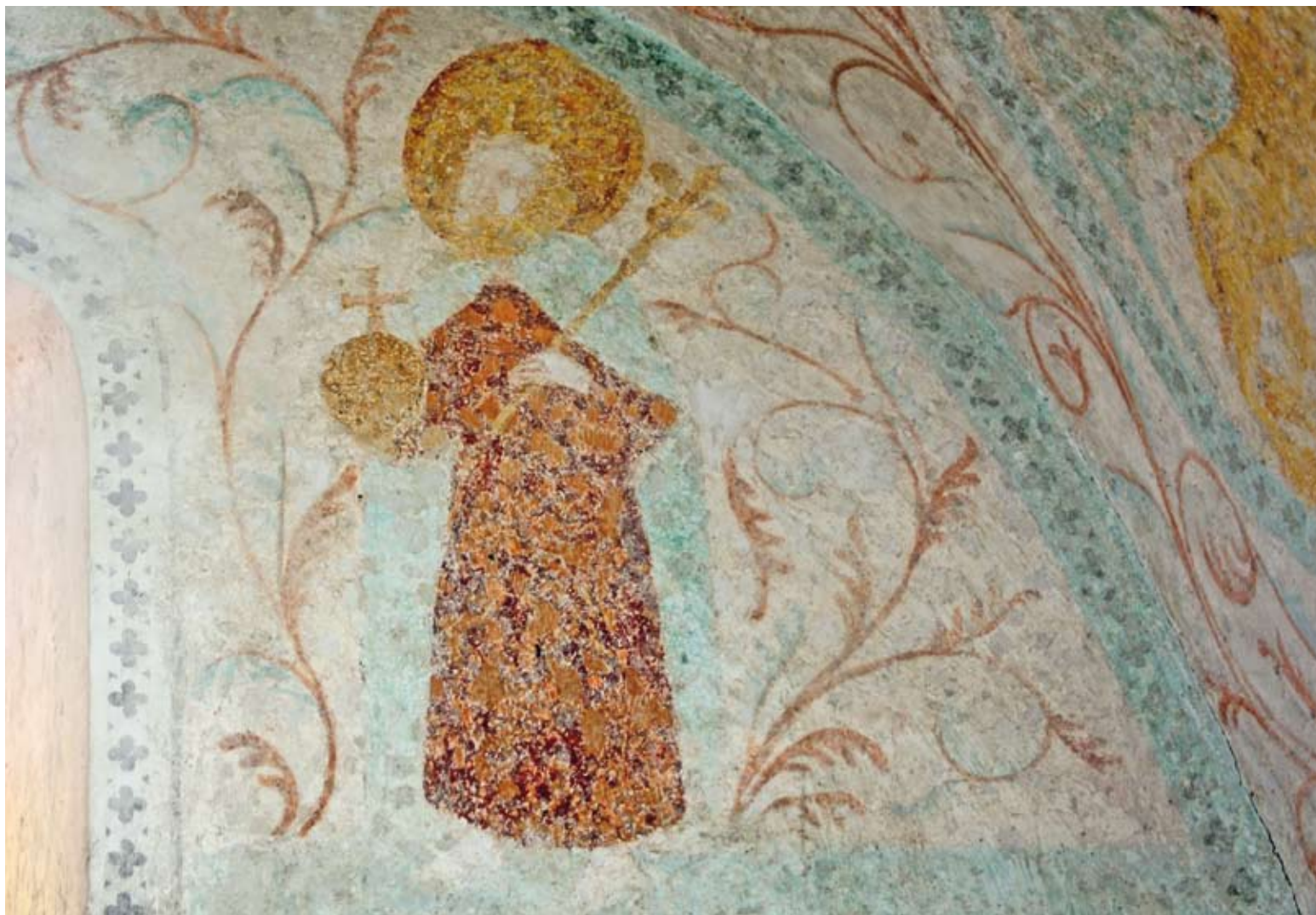
Die wertvollen Fresken aus dem 15. Jahrhundert bedürfen einer gründlichen Sanierung
