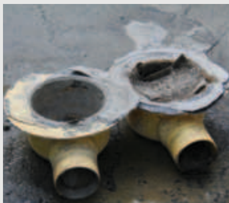
Nur zwei Abflüsse sollten das gesamte Wasser abführen.
