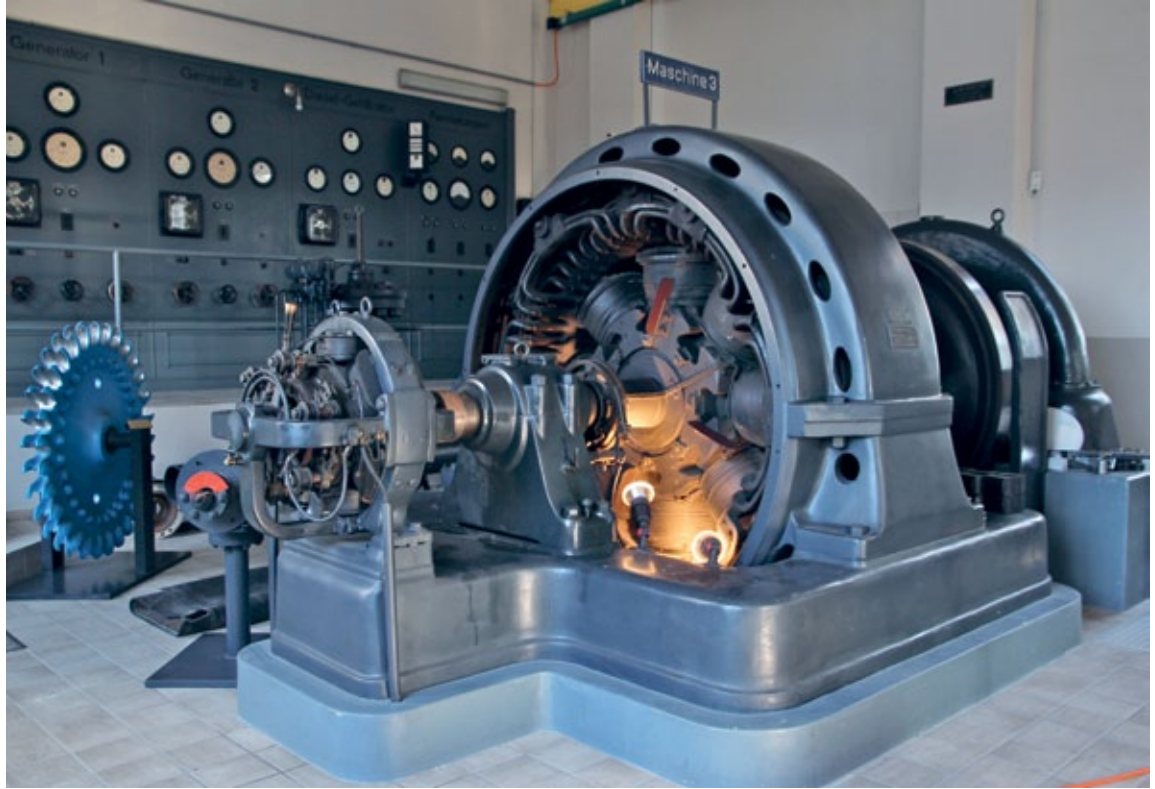
Alter Stromgenerator im Lawenawerk aus dem Jahr 1927.
