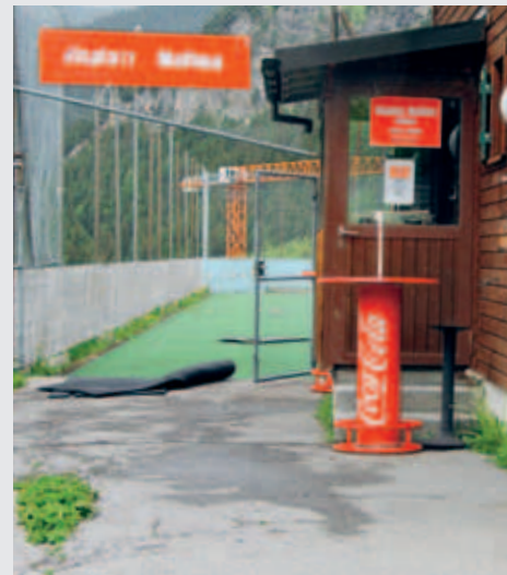
Der Eisplatz und das bestehende Gebäude sind in einem sehr schlechten Zustand.
